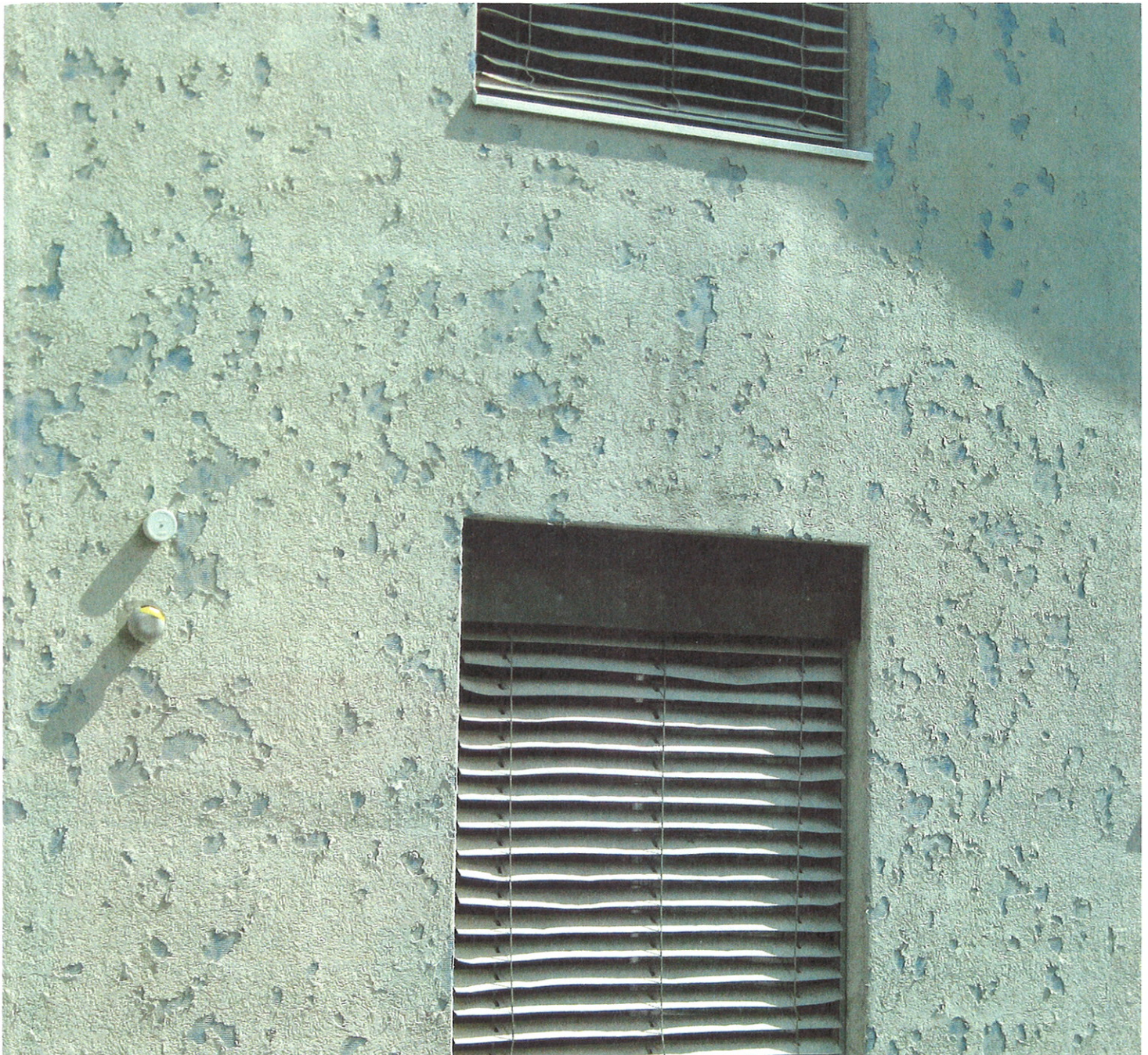
Bild 10: Fehlerhafte Appli- kation der Putzsichten?
