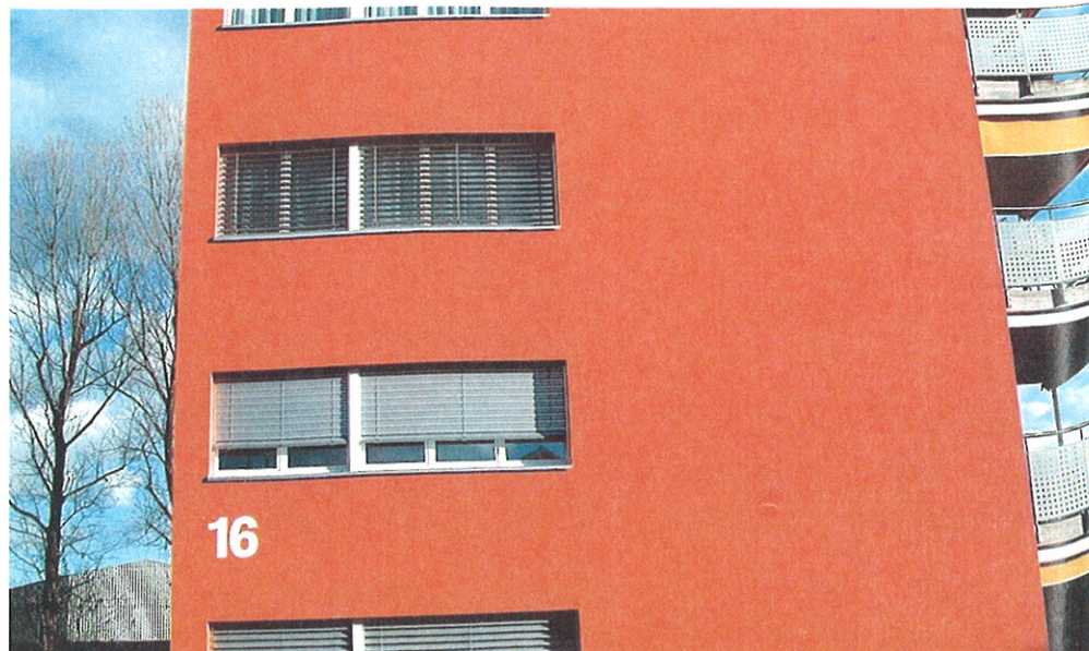
Bild 14: Wo wurden Hagelschäden saniert?
