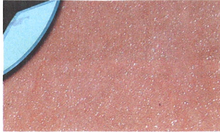
Bild 9: Beschädigte lasie- rende Farbbeschichtung.
