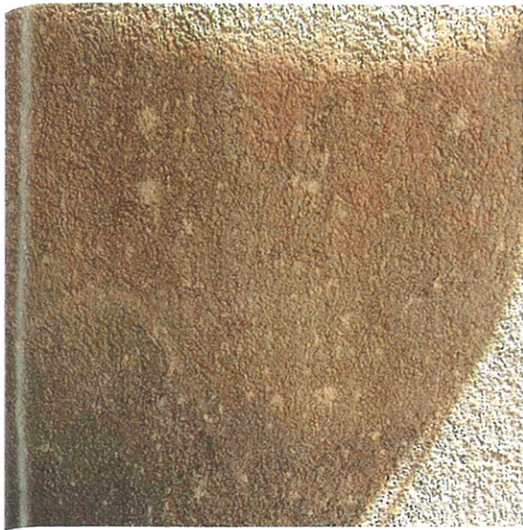
Bild 8: Durch Hagel entfernter Pilzbewuchs an einer Fassade.
